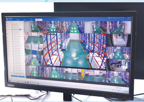
冷库监控室内的安全作业监控系统。
